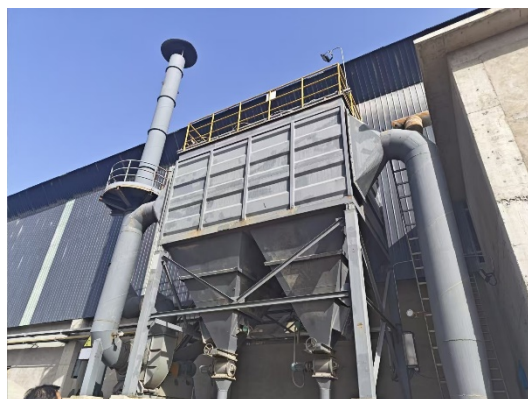
铲车投料给料除尘器及排气筒 DA001
