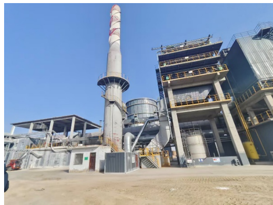
煅烧废气排气筒 DA003
