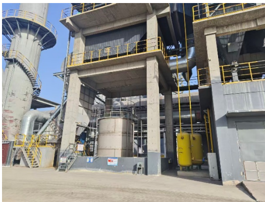
脱硝系统氨水罐及围堰
