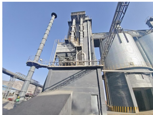
成品转载、散装除尘器及排气筒 DA006
