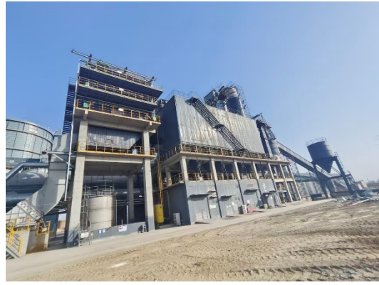
回转窑煅烧废气处理设施“钙基干法 脱硫+袋式除尘+SCR 脱硝”装置
