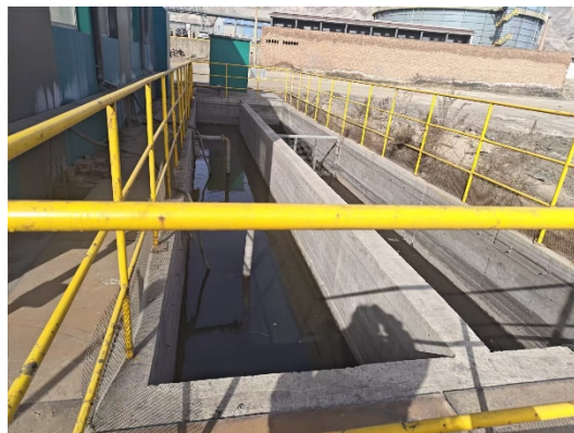
洗车平台配套循环水池
